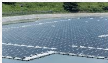
水上太陽光発電所稼働 (2015 年 10 月～)
