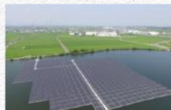
細池水上太陽光発電所(岐阜)
