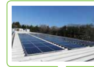
屋上に敷き詰められたソーラーパネル
