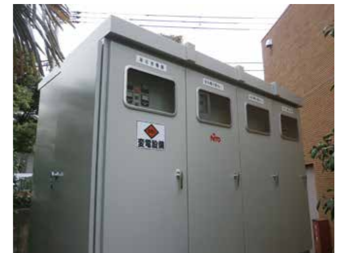
更新した受変電設備
