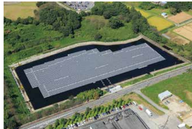
嵐山水上太陽光発電所
