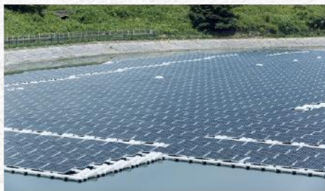
水上太陽光発電所稼働 (2015 年 10 月～)
