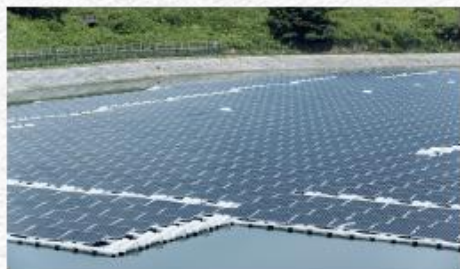
水上太陽光発電所稼働 (2015年10月～)
