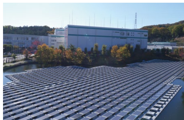
工場に隣接する水上太陽光発電所
